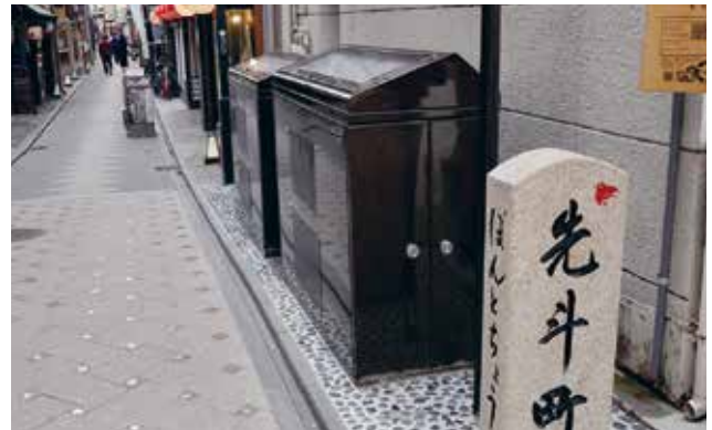
無電柱化事業で設置された地上機器は、場所に応じて覆い屋などで美化。先斗町通の入口部分の舗装は、シンボルである千鳥がデザインされている。
