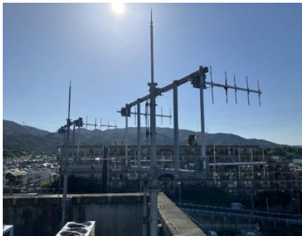
基地局アンテナ
