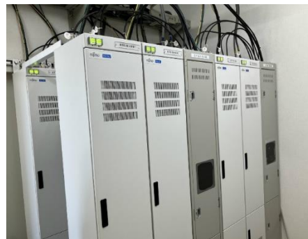
基地局無線装置
